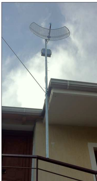
Εικόνα 5: Εγκατάσταση στο σημείο B (σπίτι)
